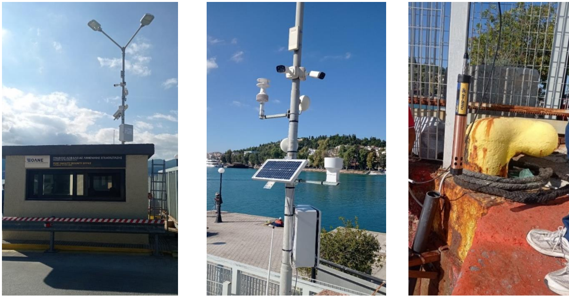
ΣΧΗΜΑ 2: Σταθμός παρακολούθησης περιβαλλοντικών παραμέτρων στο λιμάνι της Χαλκίδας.
